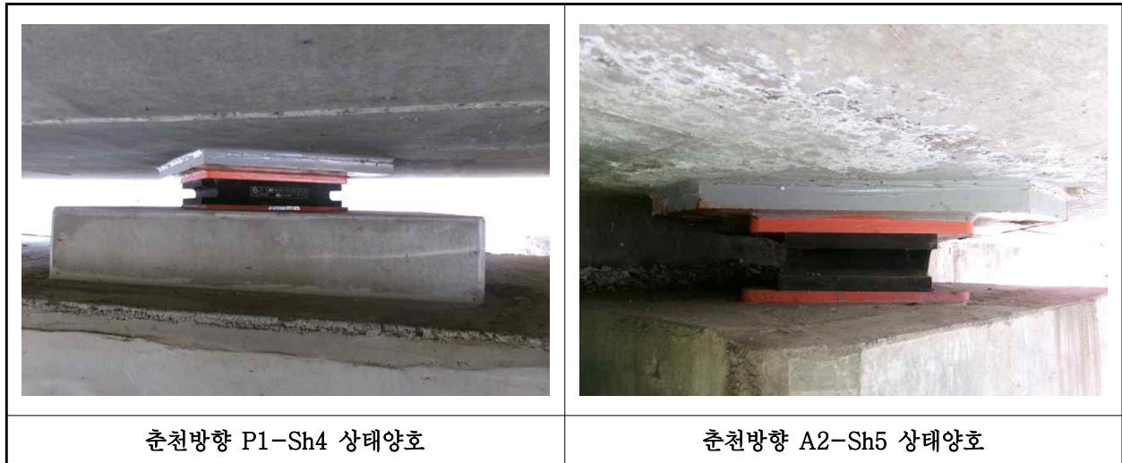
【사진 6.3.9】 교량받침 손상현황
