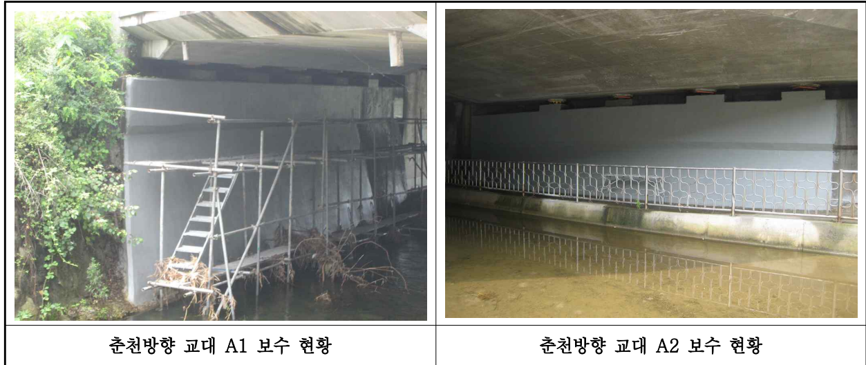
【사진 6.3.5】 교대 손상현황(계속)
